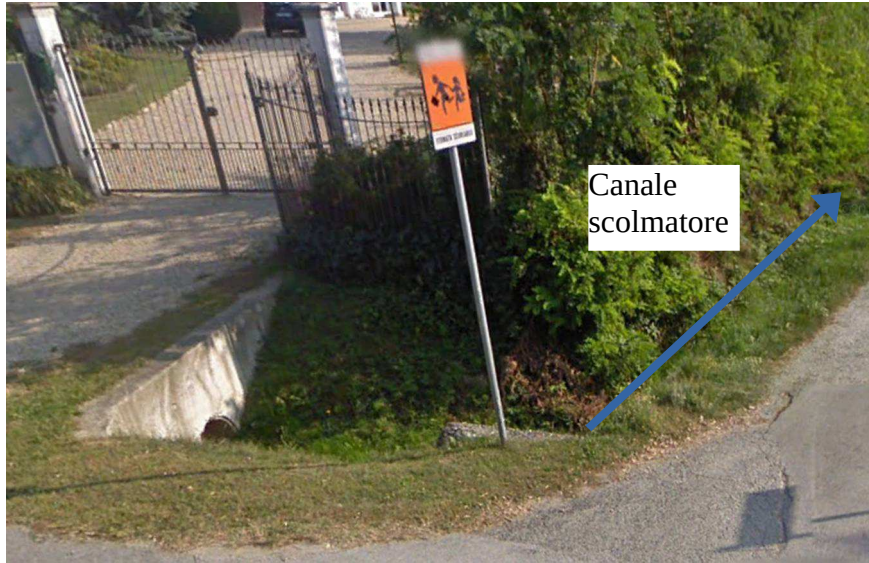
Figura 10 - Criticità 2 – manufatto di raccolta con fosso scolmatore
