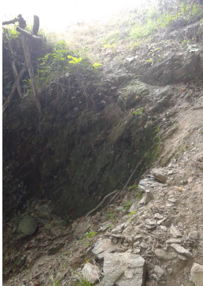
Figura 18 Tratto in frana tra borgata Ponza e l'abitato di Venasca. Coordinate UTM WGS84: 372410 - 4935436
