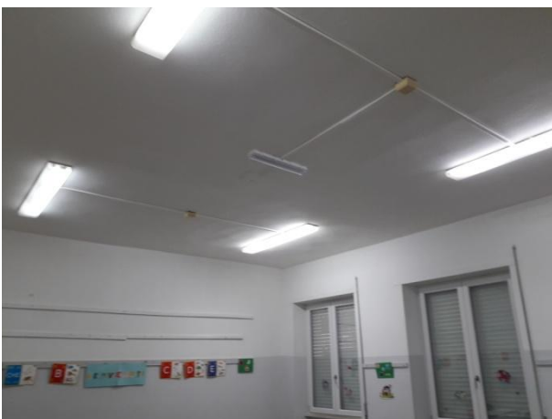
Immagine 14 (Corpi illuminanti aula scuola elementare)
