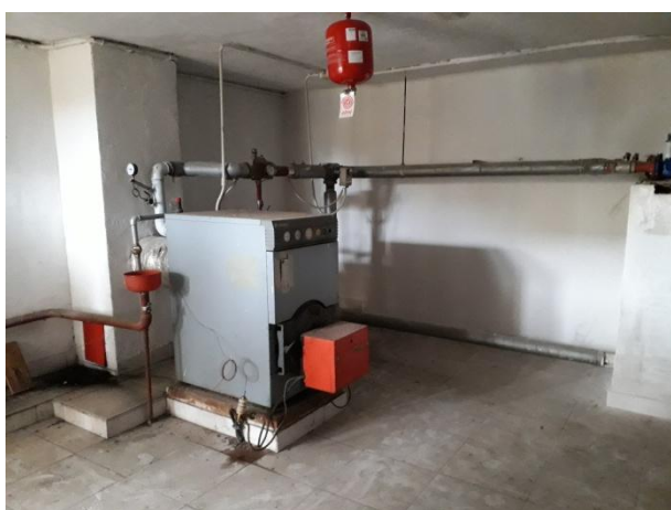
Immagine 24 (Caldaia a gasolio scuola media)
