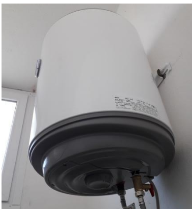
Immagine 20 (Boiler servizi igienici scuola elementare)
