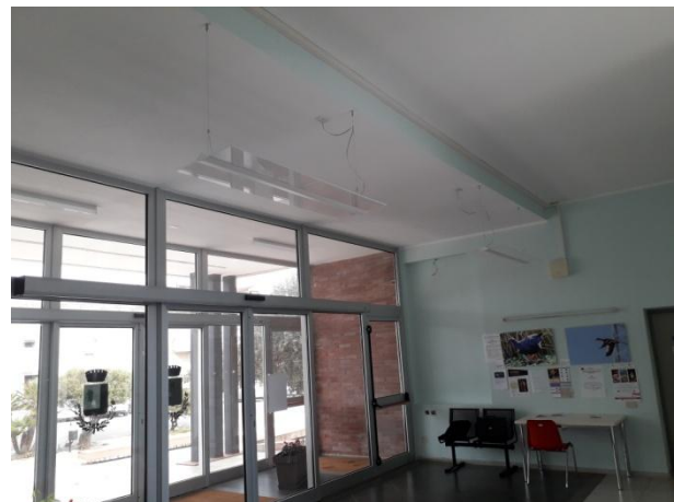
Immagine 6 (Illuminazione a soffitto ingresso principale municipio)
