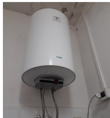
Immagine 21 (Boiler servizi igienici scuola elementare)
