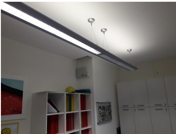
Immagine 5 (Illuminazione a soffitto uffici municipio)
