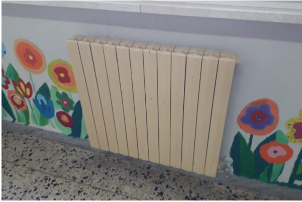
Immagine 16 (Radiatore scuola elementare)
