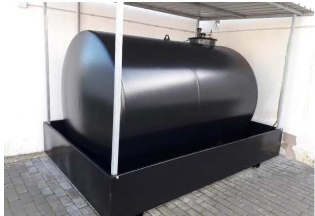
Immagine 17 (Serbatoio gasolio scuola elementare)
