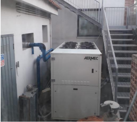
Immagine 3 (Pompa di calore aria/acqua municipio)
