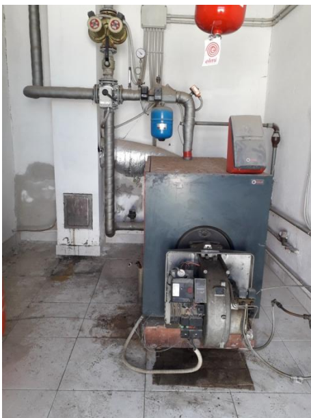
Immagine 18 (Caldaia a gasolio scuola elementare)
