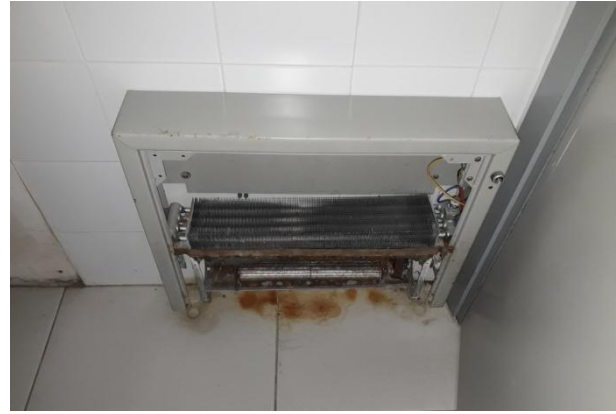
Immagine 4 (Fan Coil installato nei servizi igienici municipio)
