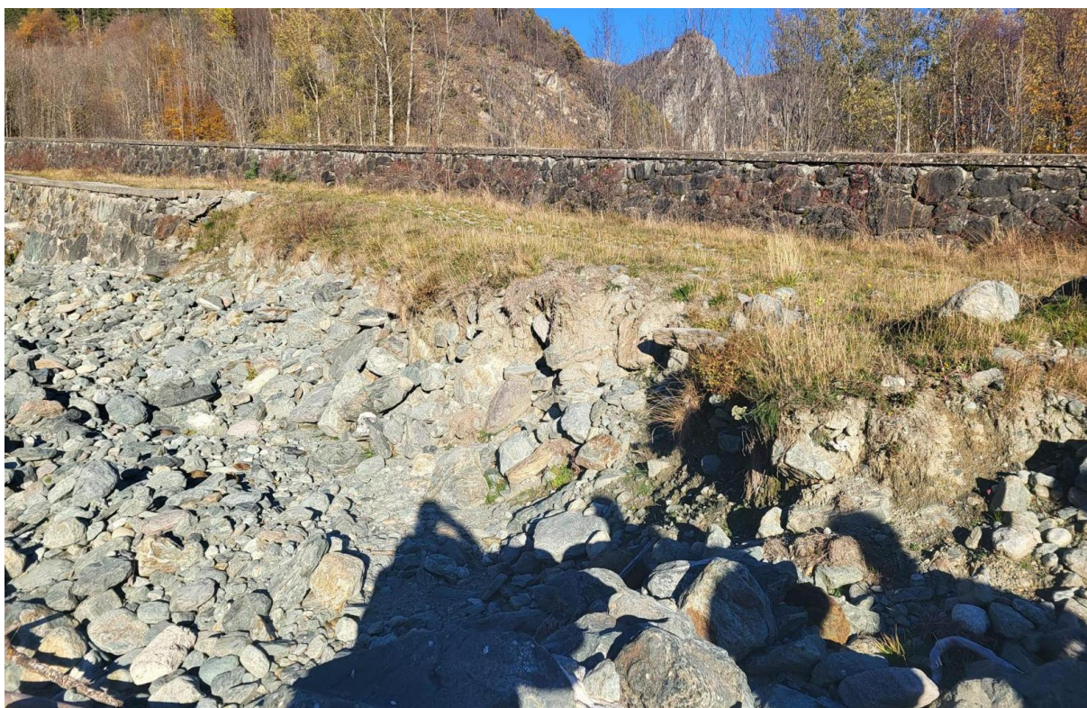
Figura 16 - Scatto fotografico della sponda sinistra erosa in prossimità del muro in pietra a protezione delle esondazioni
