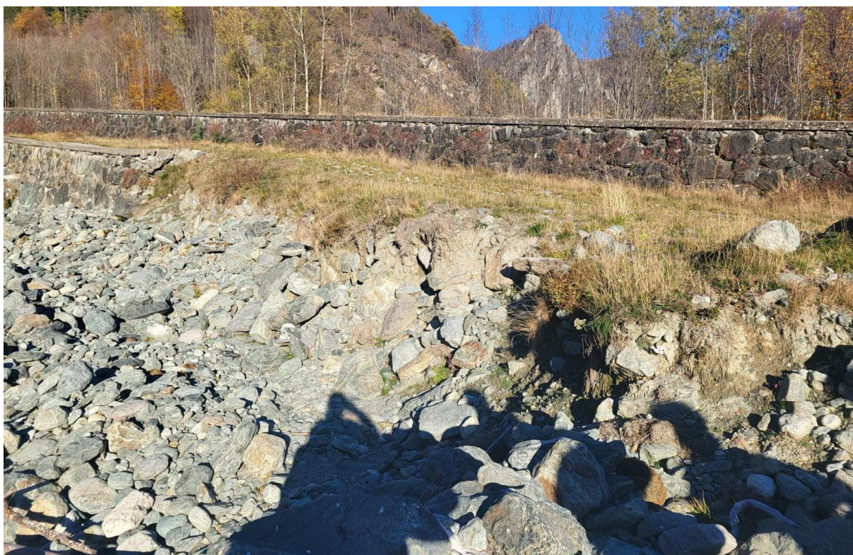
Figura 19 - Scatto fotografico della sponda sinistra erosa del Rio Venaus in prossimità del muro in pietra a protezione delle esondazioni
