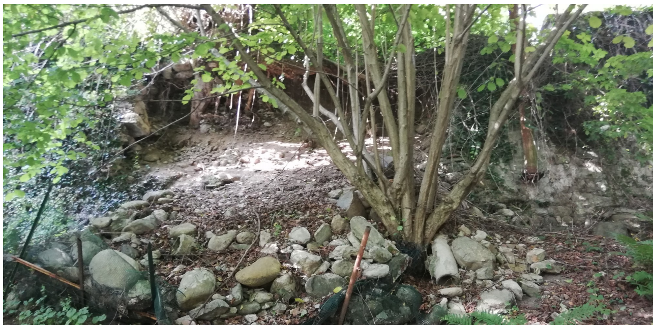
Fotografia 3 – Parte di muro crollato
