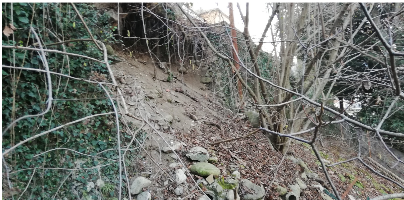
Fotografia 2 – Muro nel tratto che ha subito il crollo
