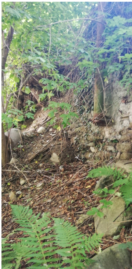
FOTO 5 – Vista laterale del muro crollato, a valle del muro, dalla riva sottostante.
