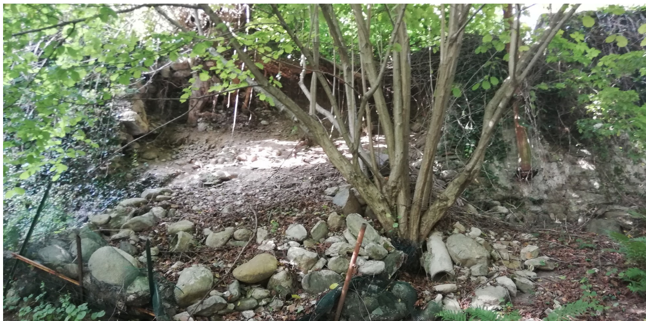
FOTO 3 e 4 – Vista frontale del muro crollato, a valle del muro, dalla riva sottostante.
