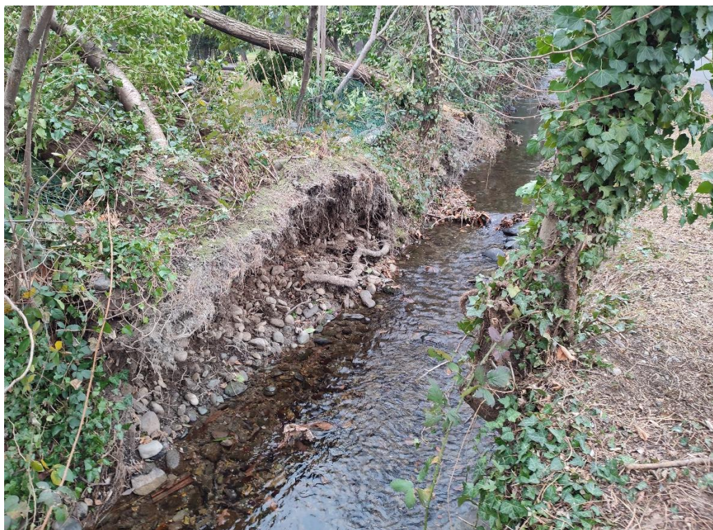
Figura 4 - Vista del canale nel tratto di intervento a seguito di un evento meteo straordinario che ha causato lo sradicamento di alcune alberature con conseguente infiltrazione e tracimazione dalle sponde in caso di tirante idrico più elevato
