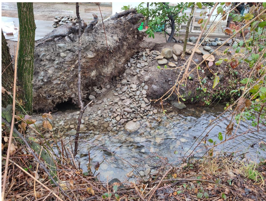
Figura 5 - Vista del canale nel tratto di intervento a seguito di un evento meteo straordinario che ha causato lo sradicamento di alcune alberature con conseguente infiltrazione e tracimazione dalle sponde in caso di tirante idrico più elevato
