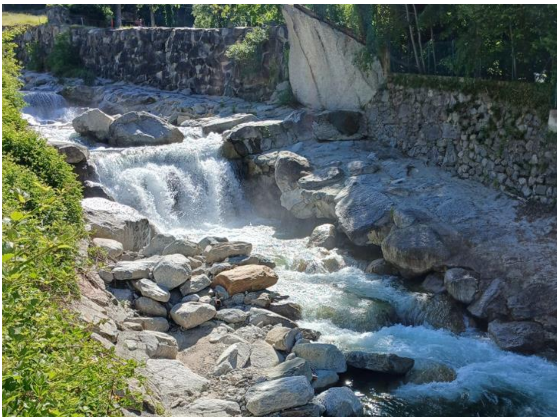
Foto 2 Erosioni delle difese in alveo del rio Vassola
