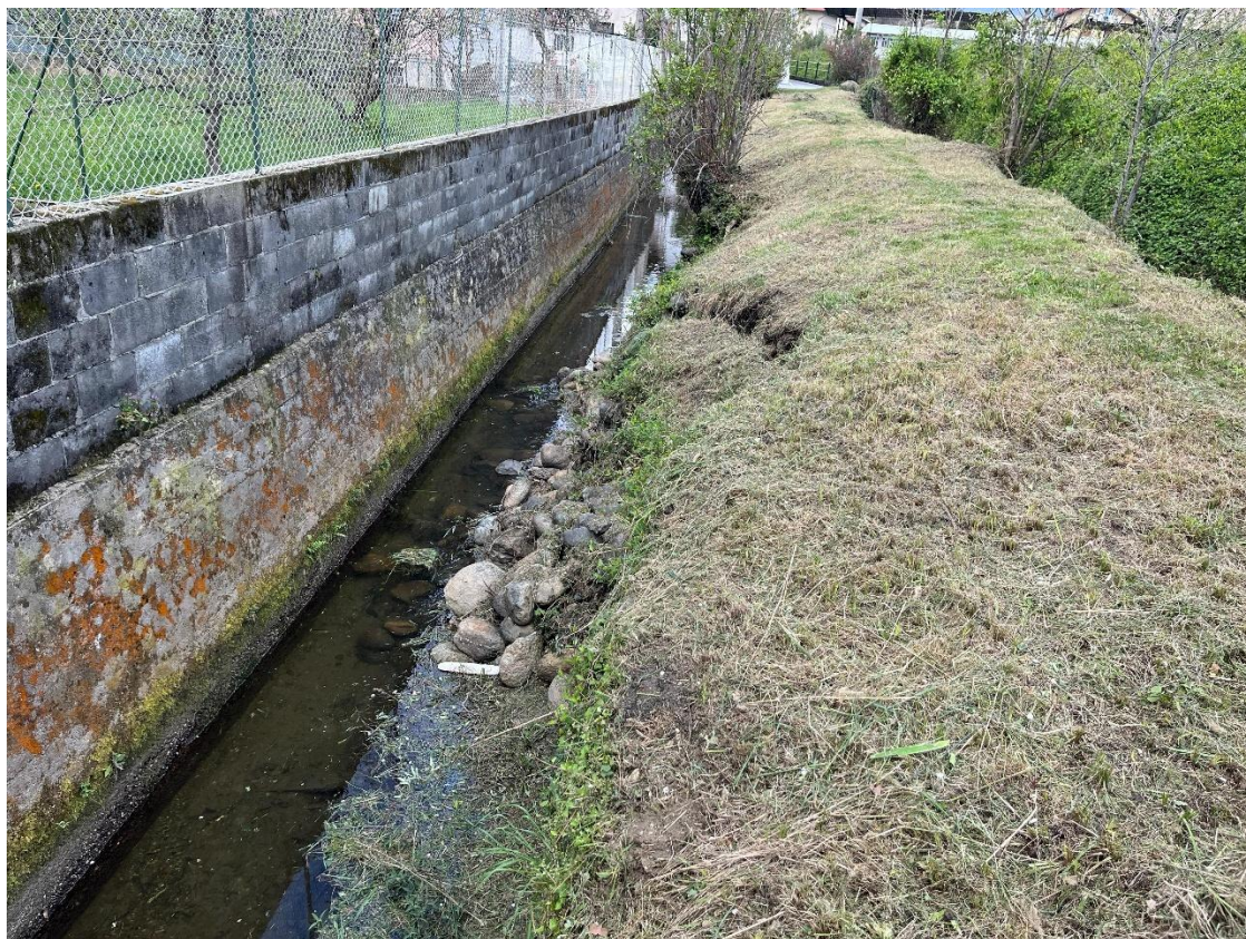
Figura 3 – Stato attuale, vista da valle verso monte – cedimento verificatosi lato canale comunale di Balangero.
