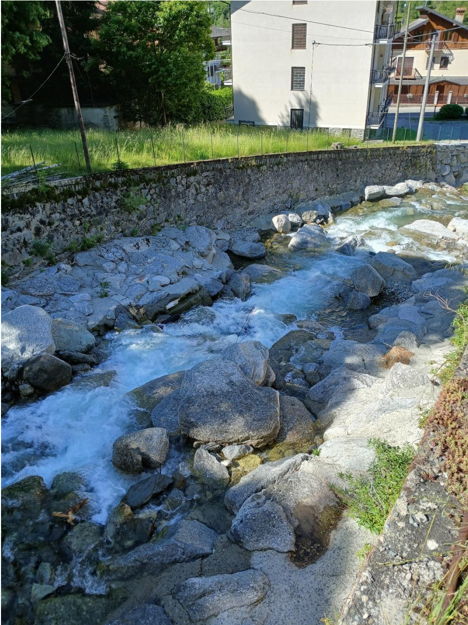
Foto 4 Vassola in ambito urbano, si notino le briglie e le erosioni esistenti
