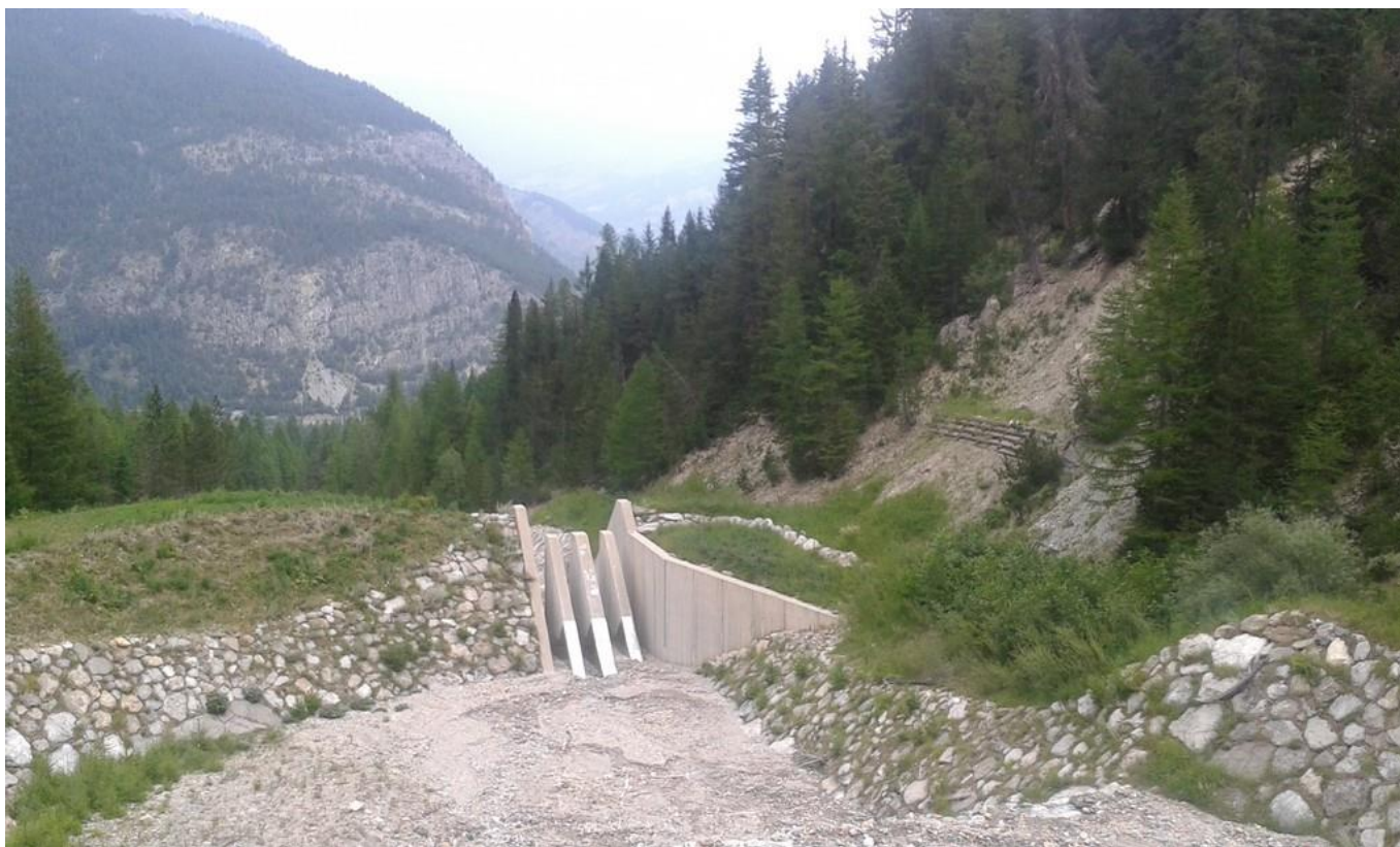
Foto 20 briglia selettiva a chiusura della vasca di deposito sul Rio Gorgia a Bardonecchia
