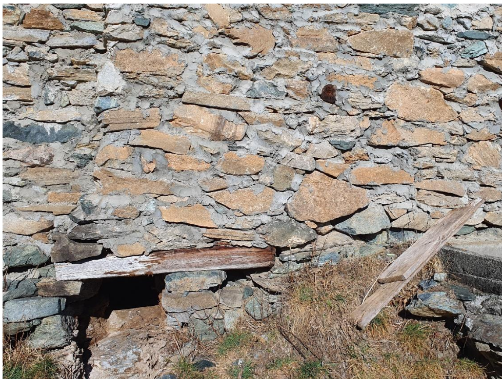
Fig. 4: particolare muro spanciante della stalla
