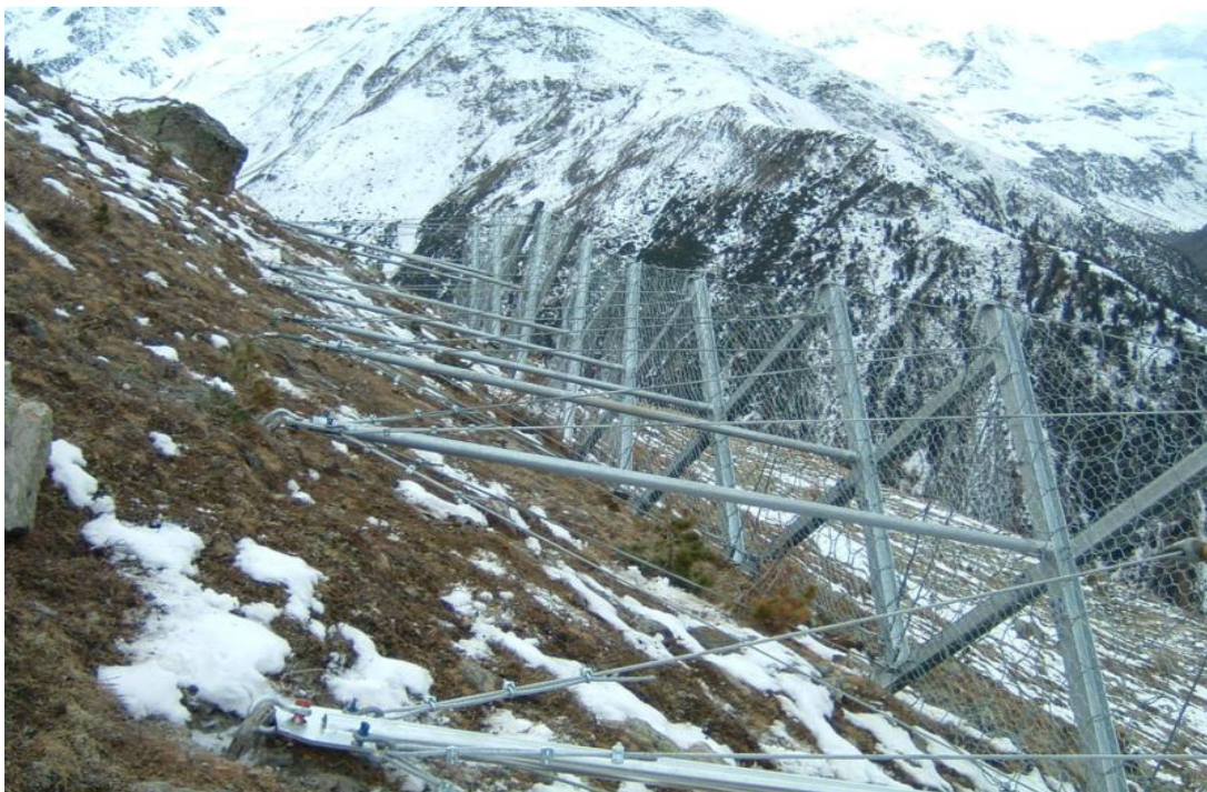
Esempio di ombrelli da neve installati in area di distacco
