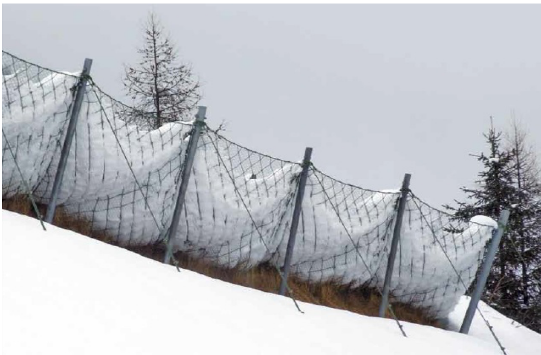
Esempio di reti ferma neve installate in area di distacco
