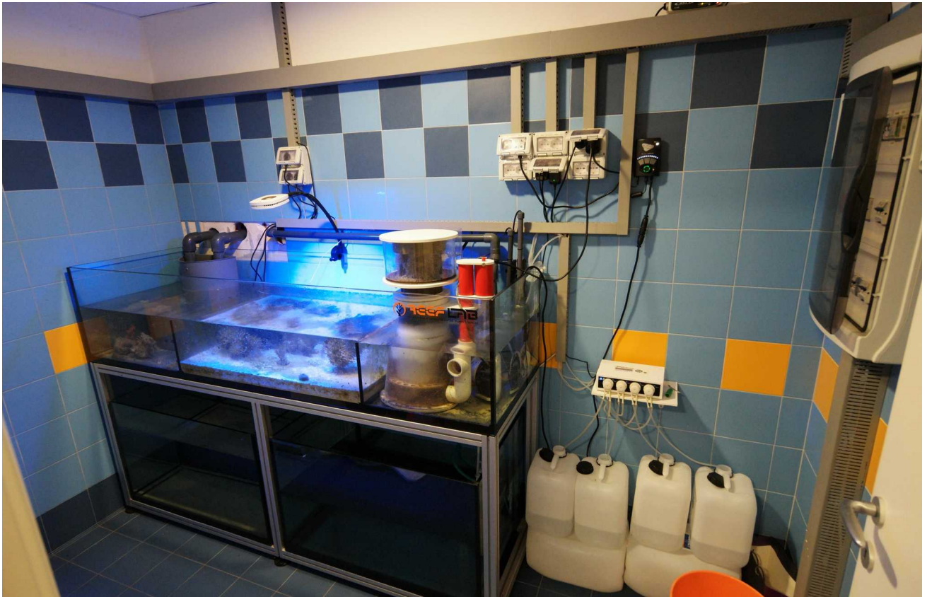
Locale dedicato agli impianti: a destra il quadro elettrico principale, a sinistra, non visibile, di fronte alla Sump, l'impianto di produzione acqua osmotica.
