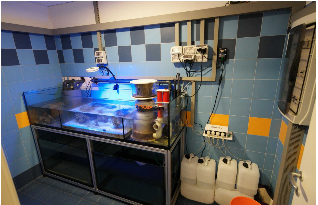
Locale dedicato agli impianti: a destra il quadro elettrico principale, a sinistra, non visibile, di fronte alla Sump, l’impianto di produzione acqua osmotica.
